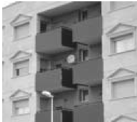
Edifici nou preparat per la instal·lació d'antena parabòlica col·lectiva i on s'observa una d'individual
