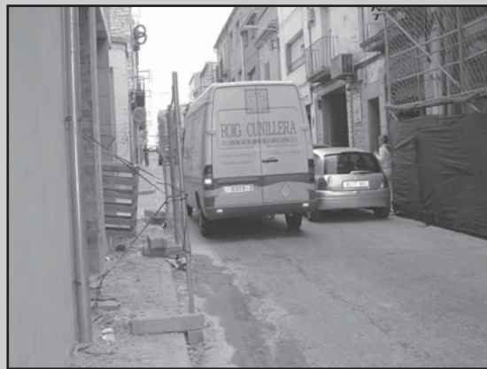
Multitud de voreres de Tàrrrega col·lapsades per les obres, impeding el pas als vianants
